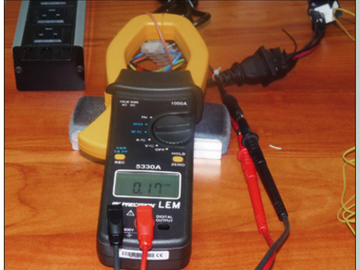
Figura 7. Medida de potencia aparente: 0.17 KVA
