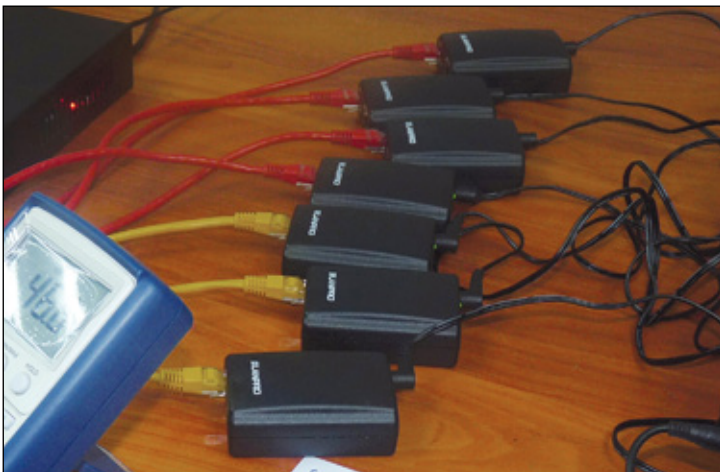
Figura 12. Splitters conectados al Switch PoE
